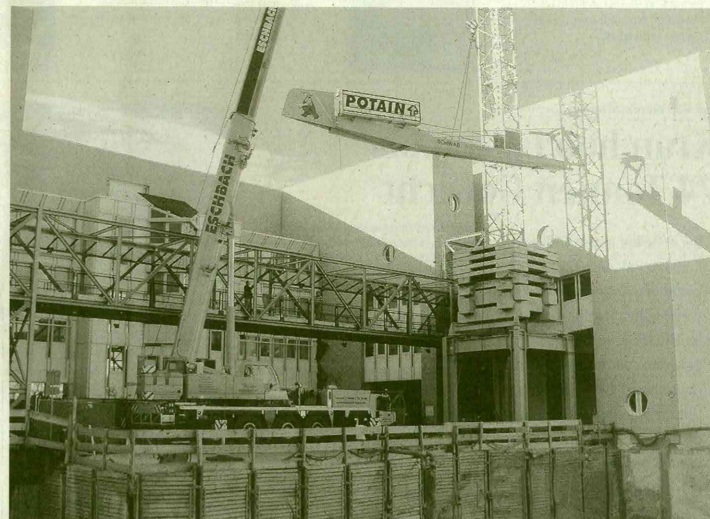
Für die eigentliche Montage des MDT178 wurde auf einen 130-t-Autokran mit 60-m-Grundmast und 42-t-Gegengewicht zurückgegriffen.
